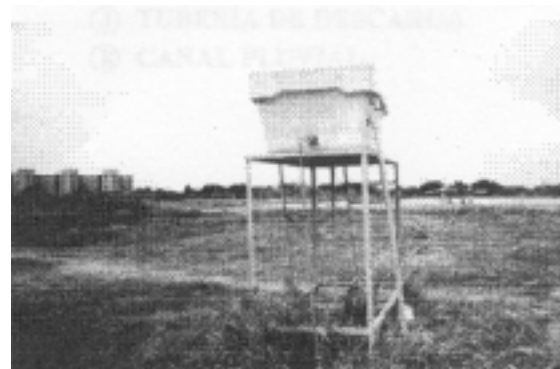
Figura 5. Tanque elevado y sistema de bombeo.
