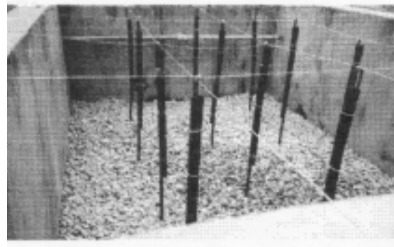
Figura 4. Vista interna del filtro antes del llenado.
