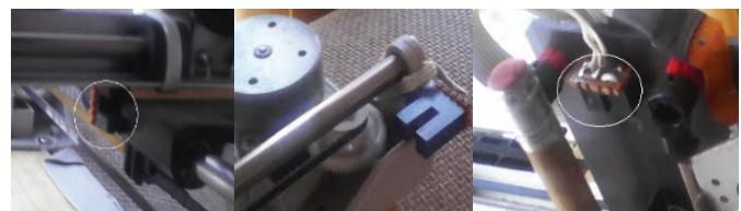
Figura 9. Sensores Ópticos de Inicio de Carrera (a: Eje X), (b: Eje Y), (c: Eje Z).
