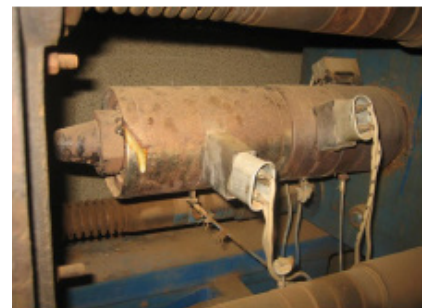
Cilindro de inyección y Termocuplas. Fuenmayor y Parra (2015)
