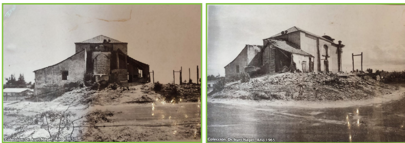
Figura 3. La Capilla Santo Cristo de Aranza en franco deterioro, vista posterior y vista lateral. Fuente: Colección Dr. Kurt Nagel (1965), facilitadas por el Padre Alfonso Rodríguez.
